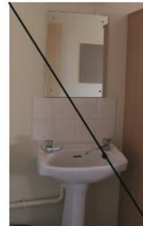
Плохо Раковина с пьедесталом. Фартук из плитки
